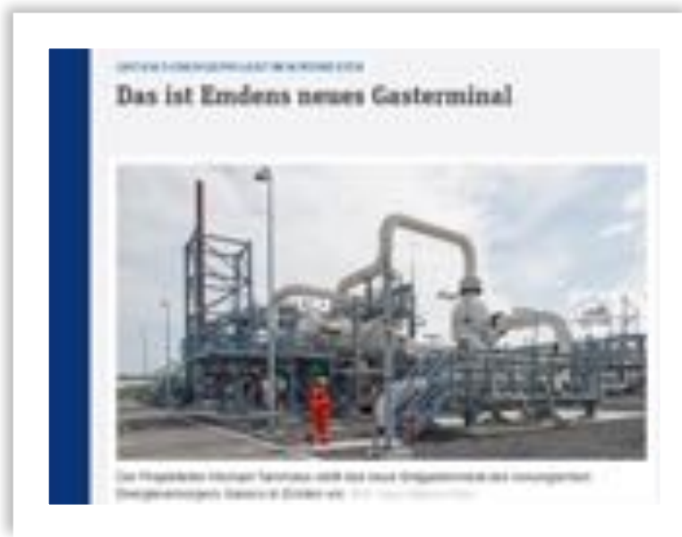
Emden: Ny mottaksterminal for norsk gass i Tyskland
